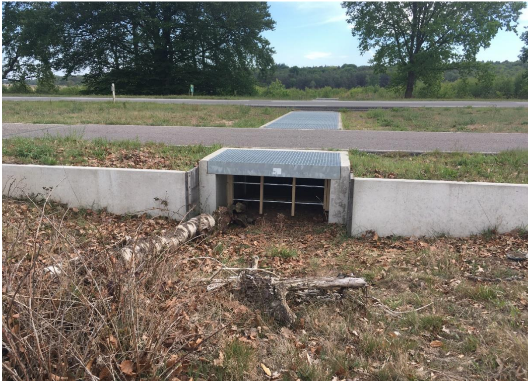
Afbeelding 2: Herpetoduct ('Oost') bij de N224; de ingang is voorzien van traliewerk om de kans op diefstal van de camerasystemen te beperken (R. Struijk).
