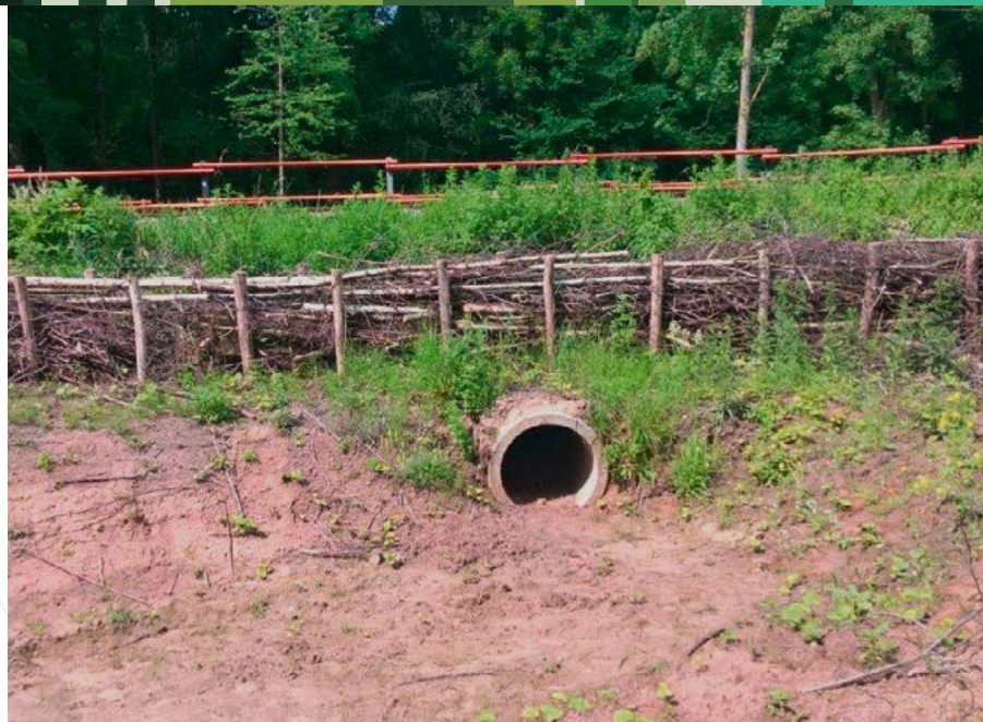
Kleine faunatunnel onder spoor bij Odijk (UT6).
