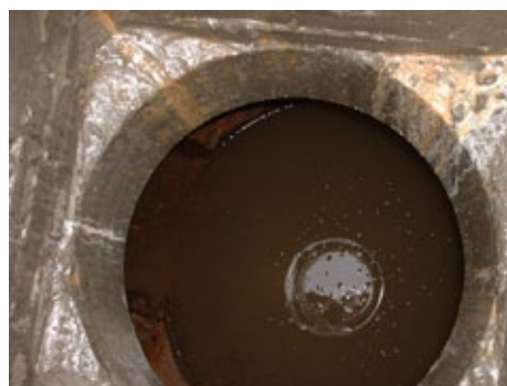
Figuur 5.9 Inspectieput vol met water.
