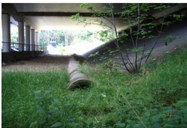
Fig. 8.80 Buis zonder aansluitende geleiding; locatie lijkt ook zonder deze buis prima te kunnen functioneren als faunapassage.
