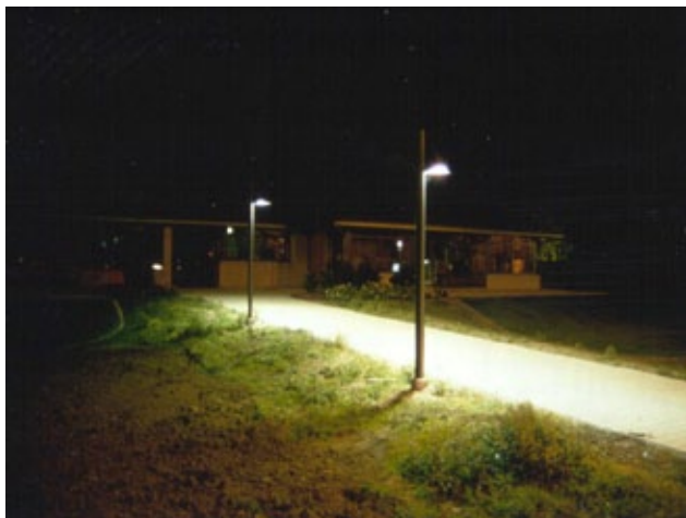
Fig. 8.155 Goed afgeschermd armatuur. Het licht schijnt alleen naar beneden.
