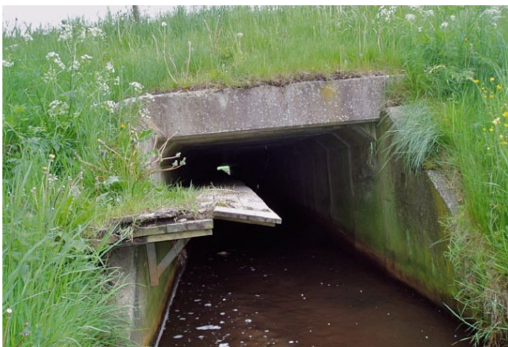
Figuur 8.111 Nadeel van een houten loopplank is dat die snel verrot en daardoor veel onderhoud vergt en of regelmatig moet worden vervangen.
