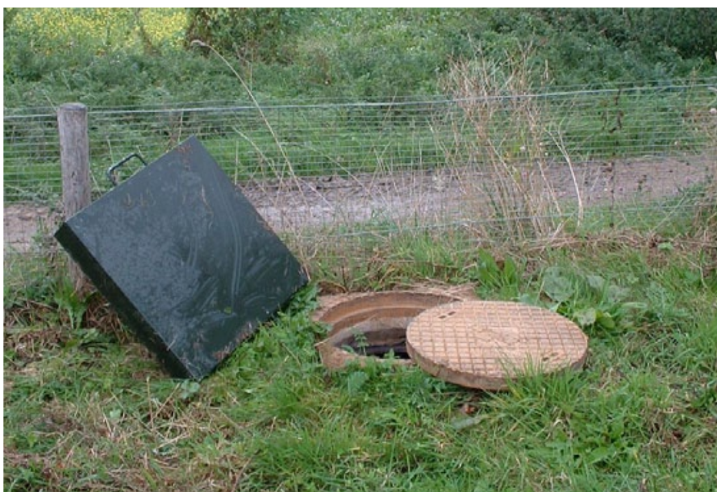
Fig. 8.160 Inspectieput met goed afsluitbare deksel, putdeksel type zwaarverkeer is niet waterdicht; waterdicht maken met stalen deksel die past om gehele gietijzeren putgedeelte.
