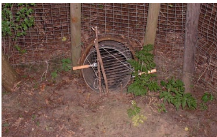
Figuur 8.129 Inspectie van faunavoorzieningen: tunnel is dichtgezet.
