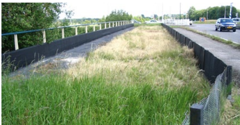
Figuur 8.93 Natuurlijk ingerichte strook op een viaduct over de A27 bij Bilthoven, bedoeld voor das en kleine zoogdieren: de schermen verhinderen verlichting van de strook door het passerende verkeer boven- en onderlangs.
