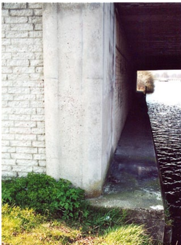
Figuur 8.109 Betonnen looprichel die met een eenvoudig verbindingsstuk tot een geschikte faunapassage gemaakt kan worden.
